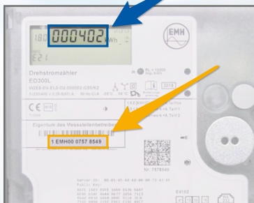
1EMH007578549 - Zählerstand: 402 kWh
